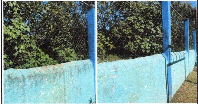
FOTO 8: Se observa daño en malla de muro perimetral.
