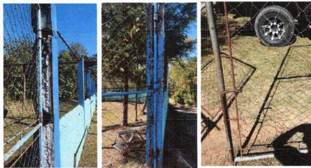
FOTO 7: Se observa deterioro en columnas de concreto y daños en portón.
