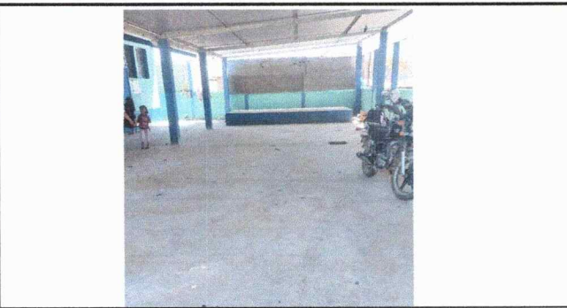
FOTO 11: para este espacio se necesita colocar piso cerámico debido a que queda atascado el lodo y polvo de quienes caminan sobre él.
