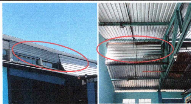
FOTO 9: se observa falta de ventana en la parte superior de aula.
